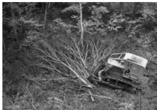
Figure 1. Préparation de terrain avec bouteur Caterpillar D6C dans une coupe par trouées en peuplement mélangé.
