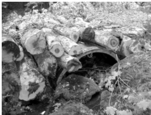
Figure 2. Des rondins contribuent à protéger l'arche et à répartir la charge imposée par le passage des machines.
