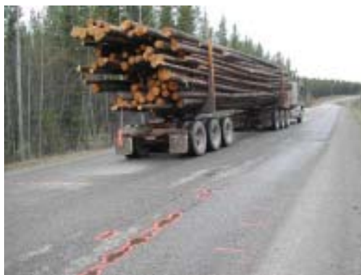
Figure 1. Camion grumier de type tridem moteur avec remorque tridem à poutre télescopique, équipé d'un TPCS, franchissant la section d'essai 9 sur Tibbles Road. La flèche indique les dommages de surface avant l'essai.
