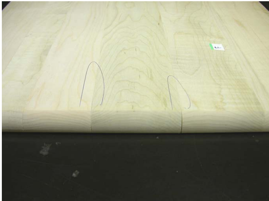
Figure 8 Joints apparents : joints ouverts en bouts
